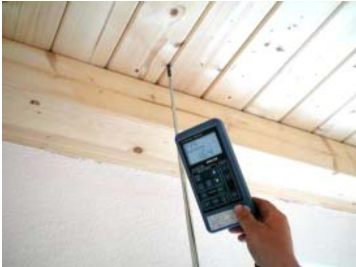
Abbildung 4: Leckageortung mittels Luftströmungsmessgerät
